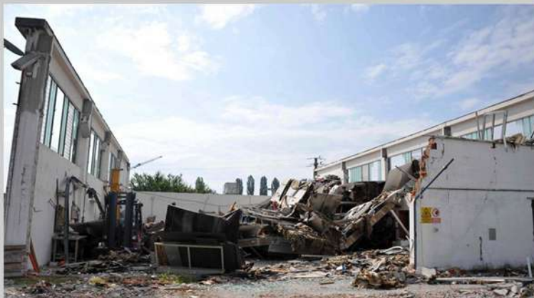
Crollo della copertura causato dalla perdita di appoggio degli elementi portanti.
