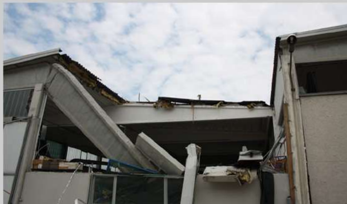
Perdita d'appoggio della trave principale in un edificio monopiano prefabbricato.
